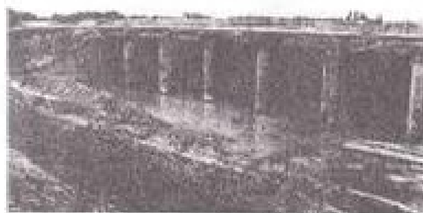
Zo zag het inlaatwerk er uit in 1996, kort nadat het was uit gegraven (foto Th.M.J. Jonker).
